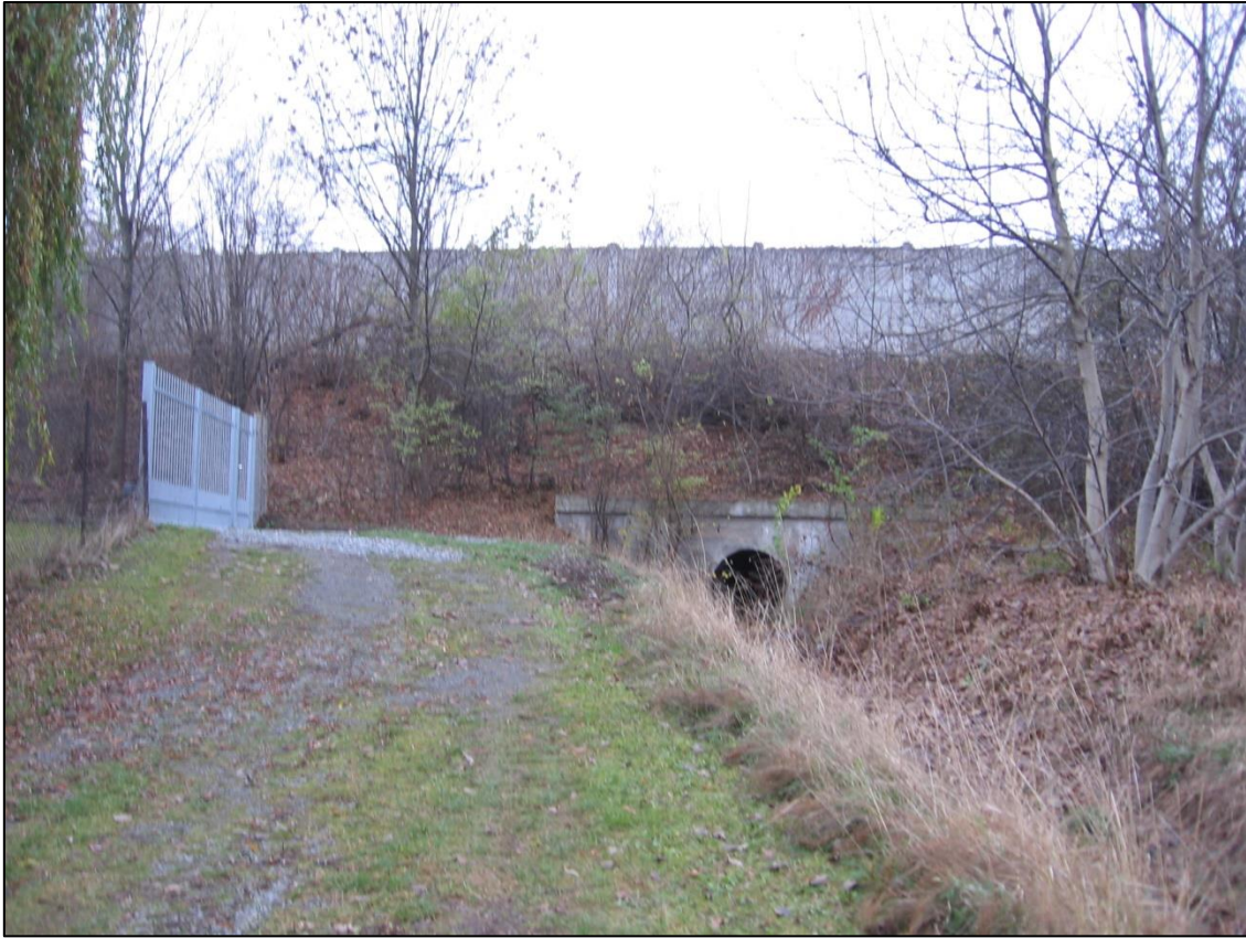
DB 20: suchý propustek bezjmenného přítoku Ořešského potoka u zahrádkářské kolonie Řeporyje II.
